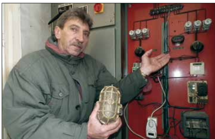
Nagy Zoltán, a Békéscsabai Lakásszövetkezet energetikusa a Petőfi utca 18. alatt a közös használatú villamos berendezés cseréjére szoruló elosztó szekrényét, illetve nem szabványos lámpatestet is mutatott.
