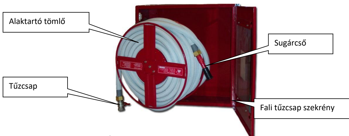
7. kép Fali tűzcsap alaktartó tömlővel szerelve.
